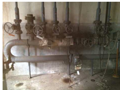
Foto 8 – ovládání výměňkové stanice v 1.PP
