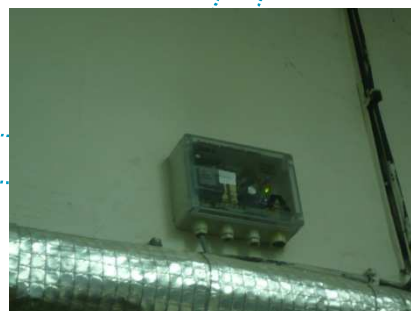
Foto 6 – detekce úniku plynu v kotelně
