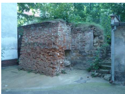
Foto 3 – místo s údajnou nevybuchlou municí
