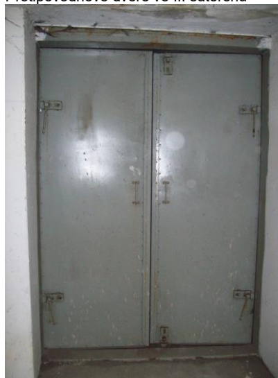
Protipovodňové dveře ve II. suterénu
