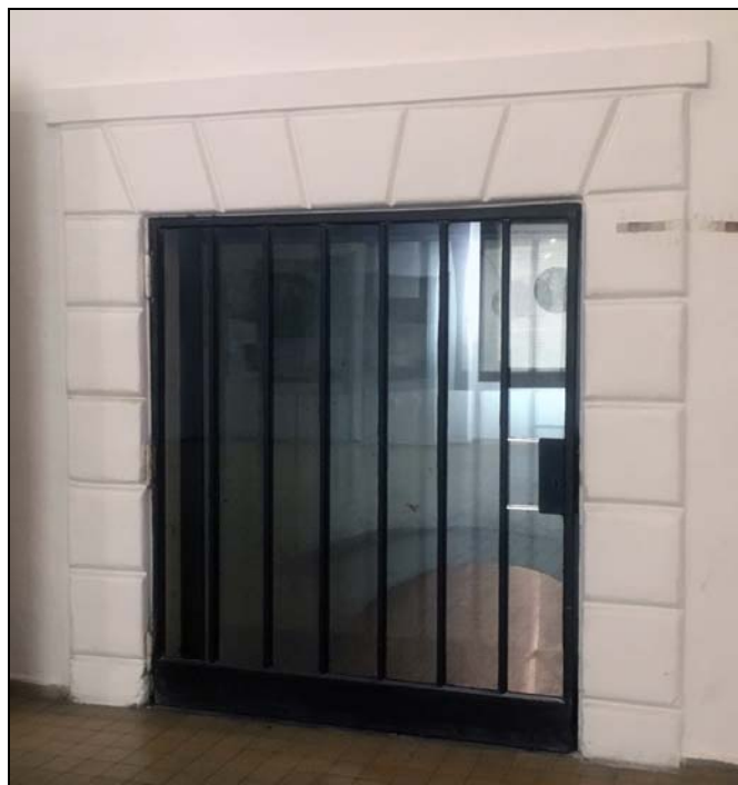
Pískovcový bosovaný portálek, který dříve sloužil k přímému vstupu do sklepů ze vstupní síně. Po 1628, nátěry novodobé, prosklená výplň po roce 1965.
